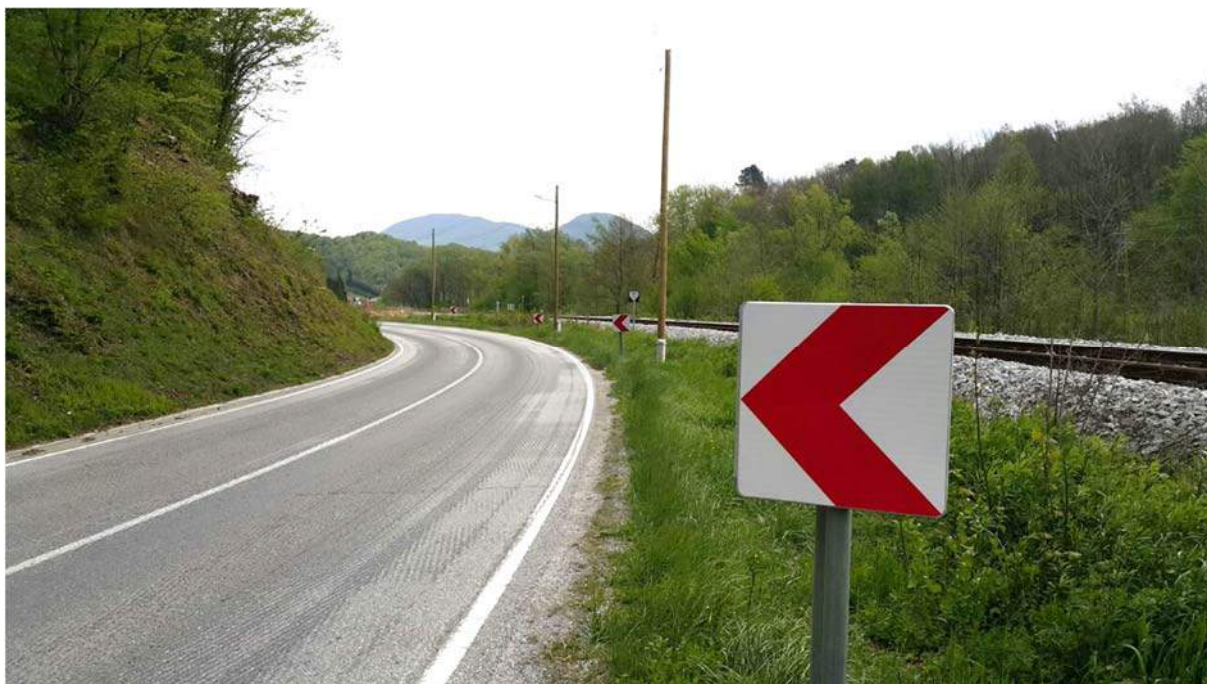
2.2.-2. Oštećenje kolnika na lokaciji
