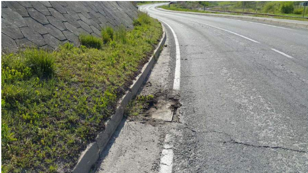
2.2.-1. Oštećenje kolnika na lokaciji
